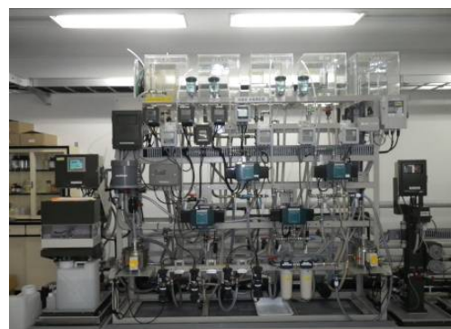
浄水処理工程の水質自動計器
