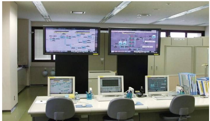
広域監視制御システム
