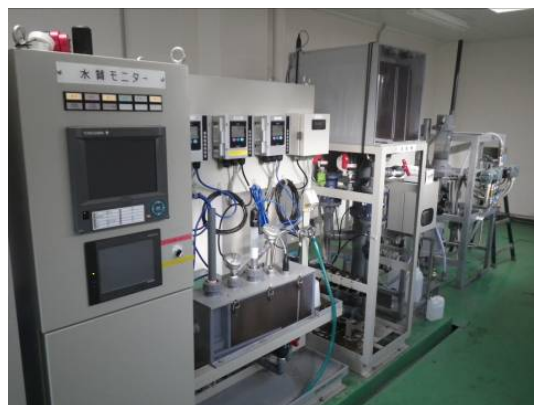
河川水質自動監視装置
